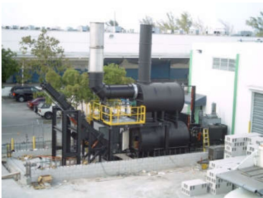
Hình 3: Lò đốt chất thải sinh hoạt rắn
